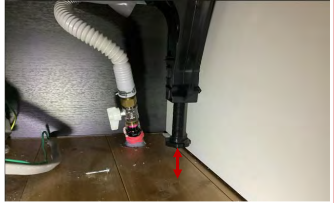
台枠が浮いている
