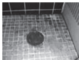
すのこを長期敷きっぱなしにして排水口が詰まり、床が汚れた状態
